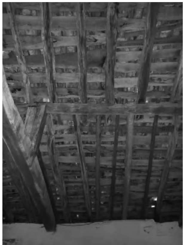
Figura 10: Estado de deterioro en que se encuentra el tejado de la nave.
